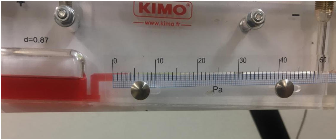
شکل ۶: مانومتر اندازه‌گیری اختلاف فشار داخل کانال
